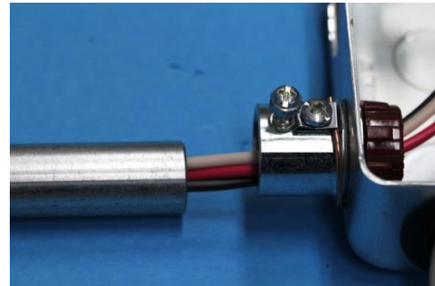
欠陥：ボックスコネクタと管との未接続 又は引っ張って外れるもの
