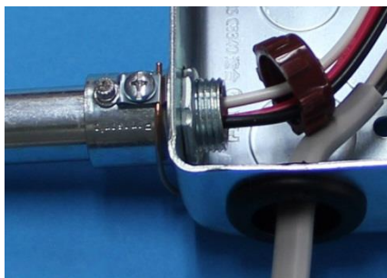
欠陥：絶縁ブッシングが外れている
